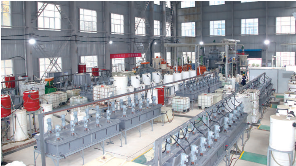
西北有色地矿集团权属研究院北矿公司高纯氯化物、氯化铯产品制备产业化示范线
