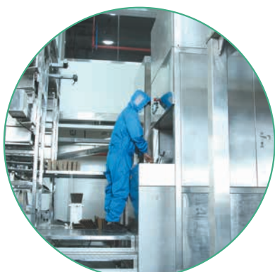
工人正在智能竖压压机前工作
