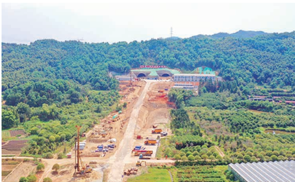
南昌市绕城高速公路西二环梅岭隧道施工现场无人机航拍图
